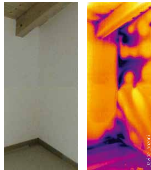
Fig. 6 Thermal bypass di infiltrazioni di aria fredda, dietro controparete interna in cartongesso, provenienti dall'angolo non sigillato tra due muri perimetrali.
